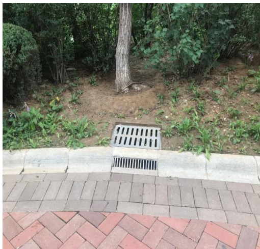
雨水收集系统
