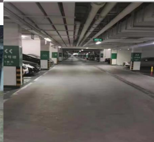
车库地面破损
